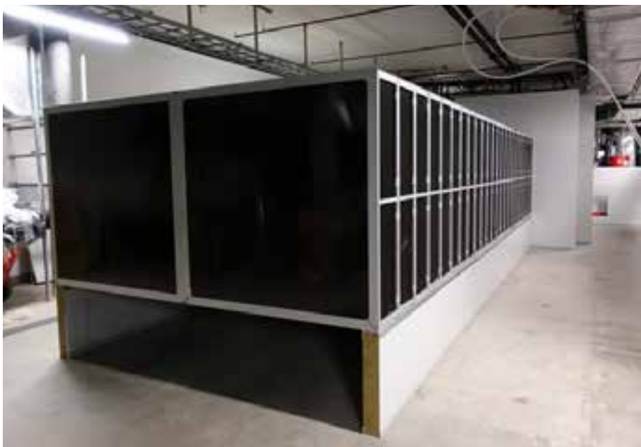
Tilpasses: Aggregatet tar form og veksleren er på plass. Aggregatet tilpasses plassen som er tilgjengelig i teknisk rom, og gir nesten 60 prosent bedre gjenvinningsgrad enn de gamle aggregatene som ble byttet ut på Gardermoen.
