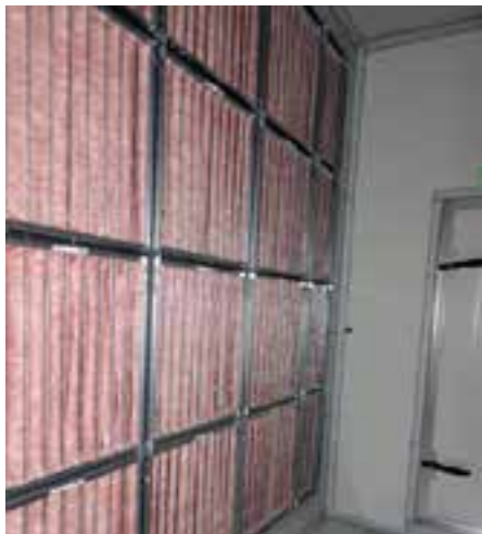
Tilgjengelig : Filtervegg med lett tilgjengelighet for skifting av filter.
