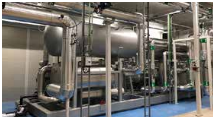
Der er gjort plads til en varmepumpe mere, skulle behovet melde sig. Foto: Høje Taastrup Fjernvarme.
